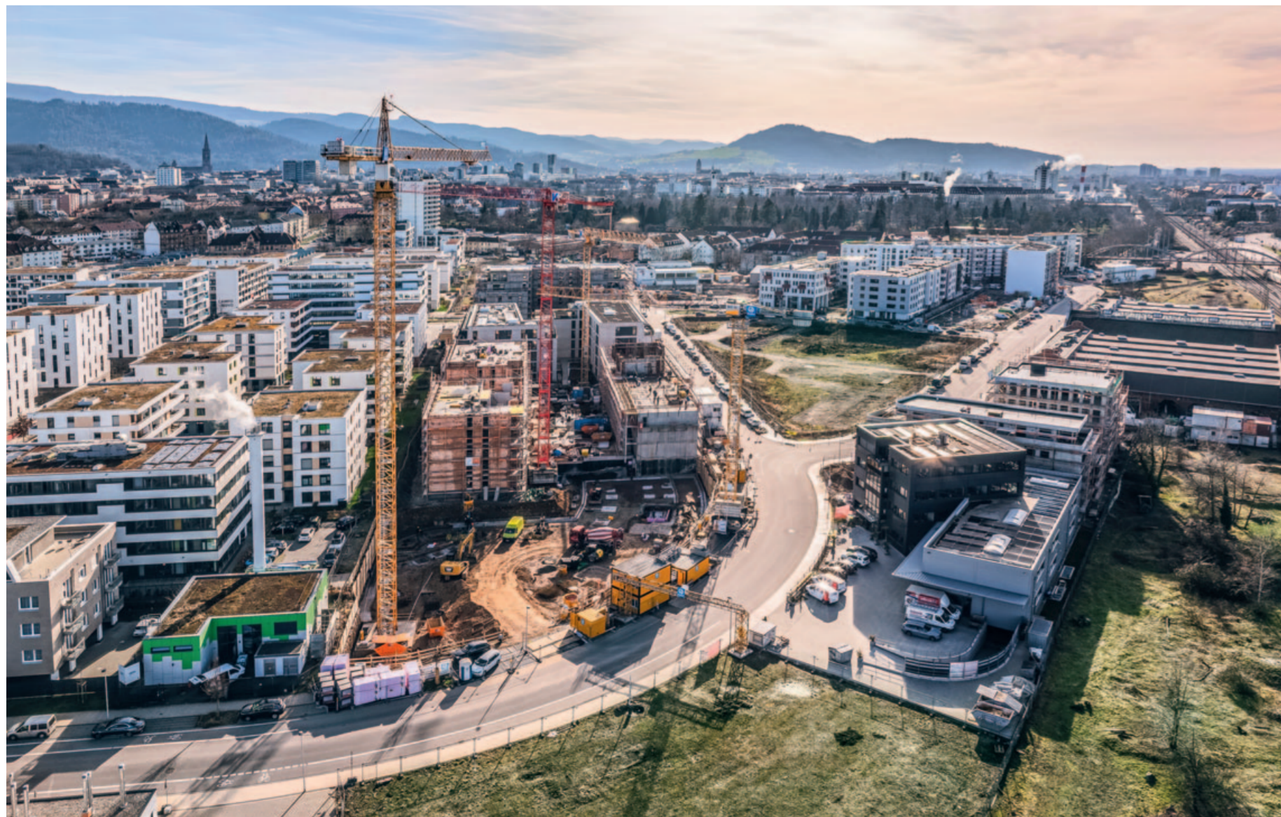
In einem markanten Schwung wird The BOW sich an die straßenseitige Grundstücksgrenze anschmiegen
